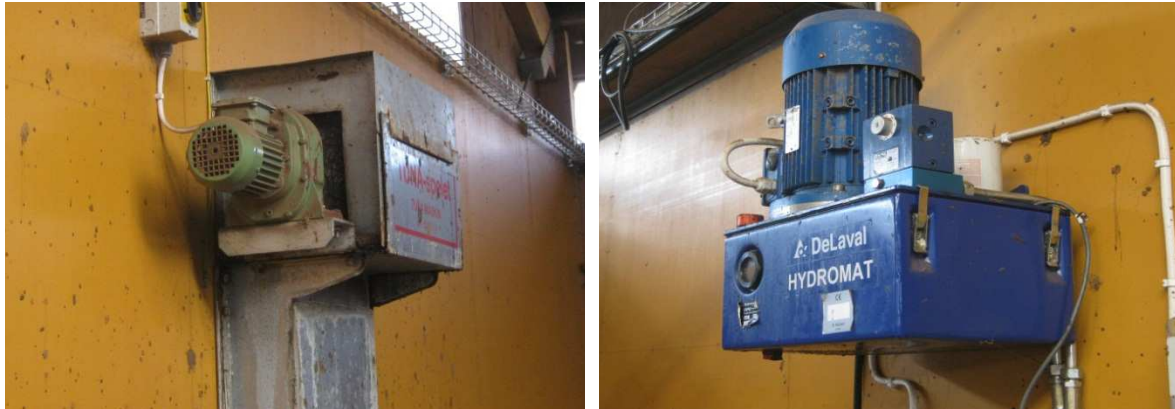
Bild 3. Skrapor på gångar och under spalt kan drivas med linspel eller hydrauliskt. Linspelen är mindre effektkrävande än den hydrauliska drivningen.
