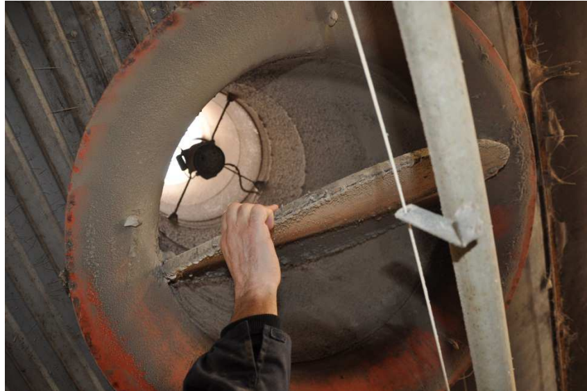
Bild 15. Oj, strypspjället hade fastnat och ja, det kanske är dags att rengöra!
